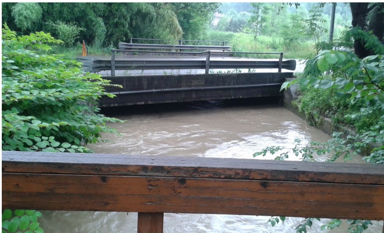
Foto 30 - Piana alluvionale di Capolago, Ponte S.P.1, livello mantenuto grazie alla soglia di sfioro di valle (16 Giugno 2016).
