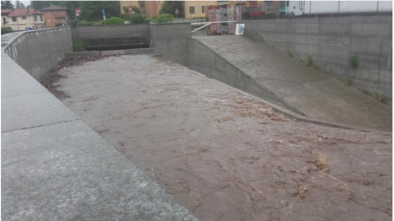
Foto 25 - Torrente Vellone, modulatore completamente invasato con scarico acque nello scolmatore (evento piovoso del 7 giugno 2020).
